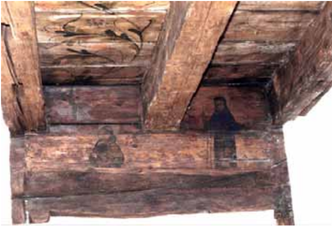
Fig. 14 : Metz, 9 rue des Murs, rez-de-chaussée, plafond, ais d'entrevous, saint François et sainte Claire , vers 1460-1480 (cl. I. Hans-Collas, 1996).
